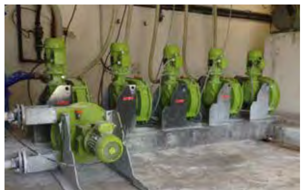
ALHX40 do mleka wapiennego w oczyszczalni ścieków
