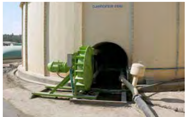
ALH100 pompująca odciek z zagęszczacza w kamieniołomie
