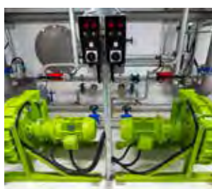
ALH65 w oczyszczalni ścieków
