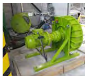
ALHX80 zasilająca prasę filtracyjną
