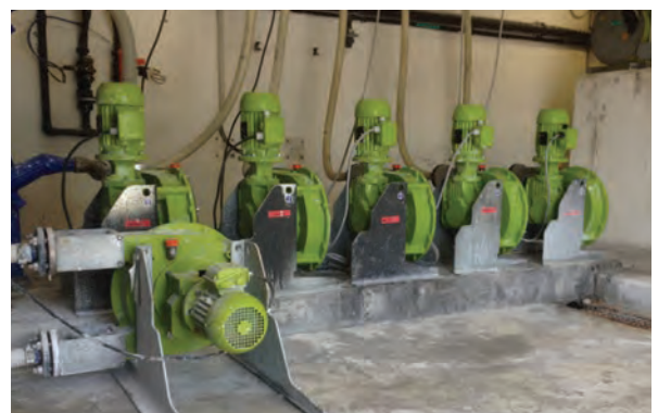
ALHX40 pour le lait de chaux dans le traitement des eaux usées
